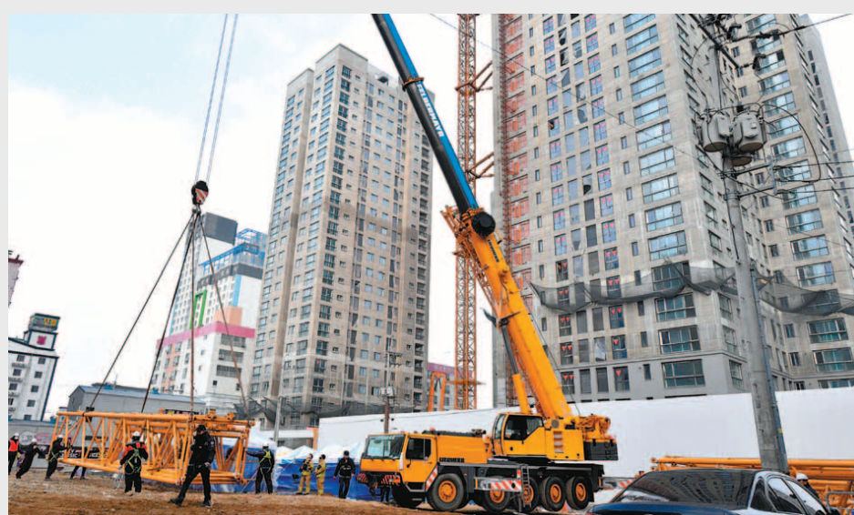
HDC현대산업개발이 정몽규 회장의 퇴진을 계기로 잃었던 시장의 신뢰를 회복할 수 있을지 관심이 모아진다. 광주 화정아이파크 사고 현장에서 파손된 타워 크레인을 해제하기 위한 1200톤급 크레인 조립 작업이 진행되고 있다. 뉴스1
